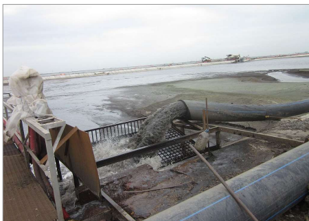
Ingresso sedimenti nella vasca intermedia
